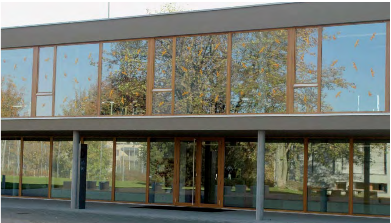
Un nouveau bâtiment d'école avec une façade en verre sur deux étages. En raison du haut degré de réflexion du verre, il y avait sans arrêt des collisions. Les silhouettes colorées ont été fixées en désespoir de cause par les élèves et le professeur de biologie. Le danger de collision a été quelque peu réduit, mais cette solution n'est satisfaisante ni du point de vue esthétique ni de son efficacité.
